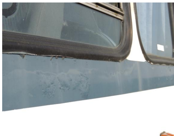
Fot. 20 Uszczelka okna
